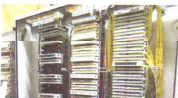
EEN VAN DE VELE SCHAKELKASTEN IN HET NIEUWE GEBOUW.
