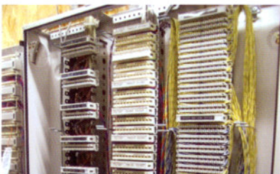
EEN VAN DE VELE SCHAKELKASTEN IN HET NIEUWE GEBOUW.
